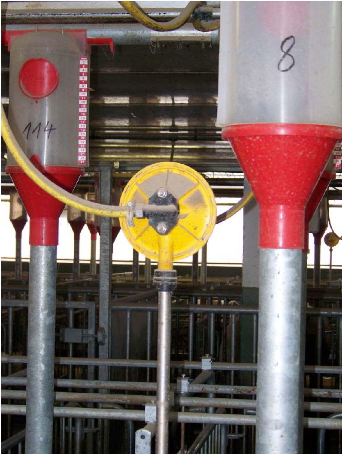
Abbildung 7: Die Tränkwasserversorgung mittels Aqualevel-System begrenzt die Wasserverluste und ermöglicht in Kombination mit Zeitschaltuhr einen notwendigen, aber geringen Wasserstand
